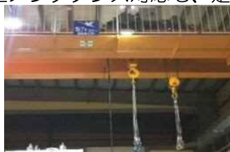
15t 天井クレーン
